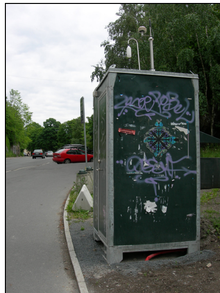
Målestasjonen i Åkebergveien i Oslo, juni 2010
